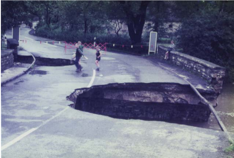
Die zerstörte Almebrücke in Büren-Wewelsburg (Foto: Kreisarchiv Paderborn)
